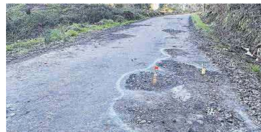
Baches en la carretera de Herbello, con marcas de su diámetro.
